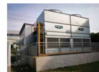
冷却塔 Cooling Tower
